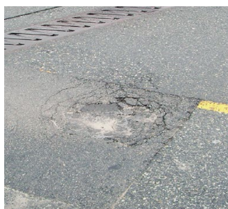
鉄筋のかぶり不足等による ポットホール
