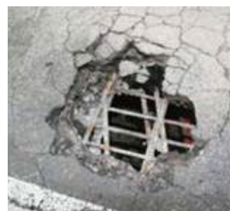
床版の疲労による 部分抜け落ち
