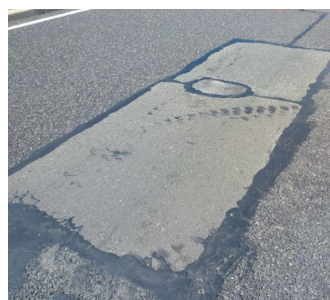
橋梁の補修跡(再劣化)
