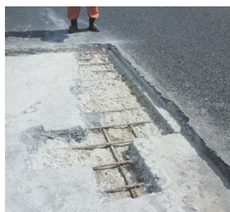
繰り返し荷重による 床版上面の損傷
