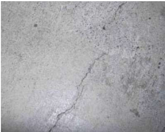
フォークリフトなどの走行で床面が荒れる 粉塵・汚れ付着
